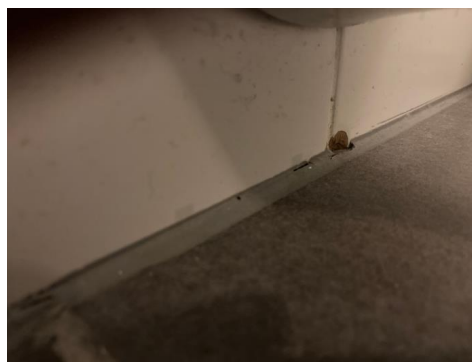
Riss i fuge/skade i flise
