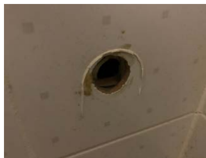
Drenering fra fordelerskap
