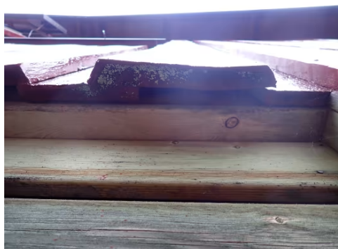
Manglende musetetting mellom kledning og veggkonstruksjon.
