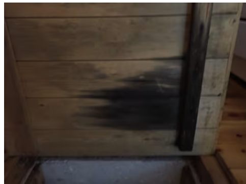
Misfarging i treverk på kjellerluke, som tegn på tidvis fukt i kjellerhullet.
