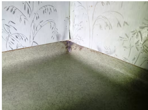
Misfarging / løsnet tapet.
