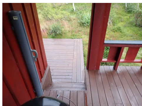
Manglende håndløpere i trapp.
