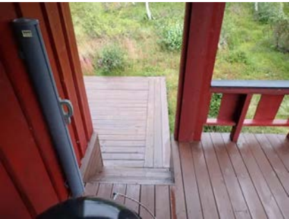
Manglende håndløpere i trapp.
