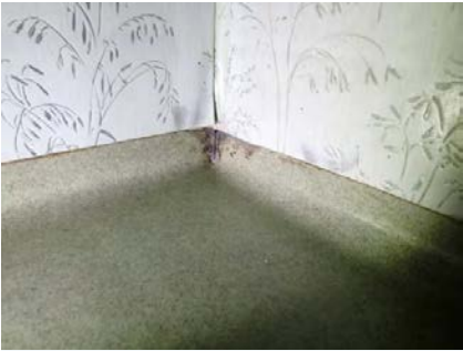
Misfarging / løsnet tapet.
