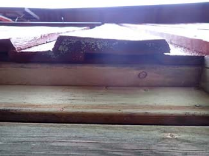
Manglende musetetting mellom kledning og veggkonstruksjon.
