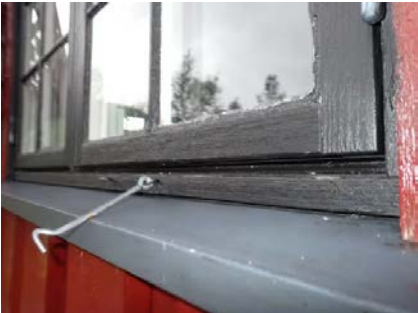
Noe forvitring/slitasje i treverk i vinduskarm.
