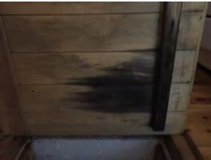
Misfarging i treverk på kjellerluke, som tegn på tidvis fukt i kjellerhullet.
