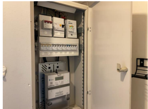
Sikringskap i 1. etasje.
