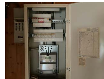
Sikringsskap i 2. etasje.
