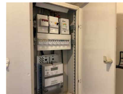
Sikringsskap i 1. etasje.
