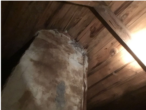
Fukt merker i undertak ved pipe
