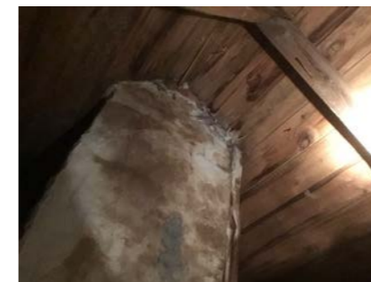
Fukt merker i undertak ved pipe
