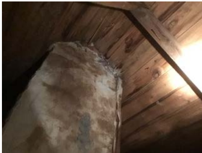
Fukt merker i undertak ved pipe
