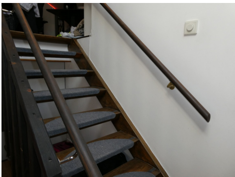
Rekkverk og håndløpere med lav høyde.
