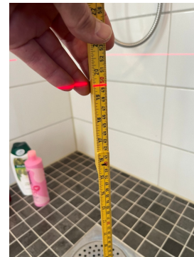
Målt høyde 49,5 cm ved sluk, fall er kun 5 mm fra terskel og lokalt fall i dusj. Fall under krav
