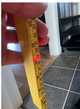
Kontrollert fall på gulv, målt med laser og høyde er 49 cm ved terskel
