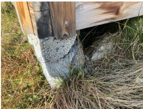
Sprekk i fundament som er satt rett på grunn
