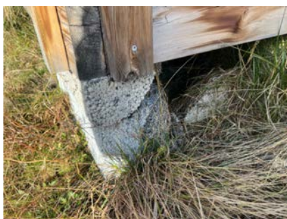
Sprekke i fundament som er satt rett på grunn
