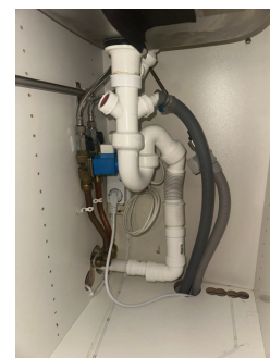
Rørplegg i kjøkkenbenk med Waterguard
