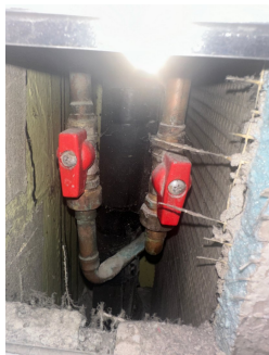
Stoppekraner plassert i luke på bad
