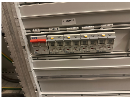
Sikringsskap med automatsikringer.
