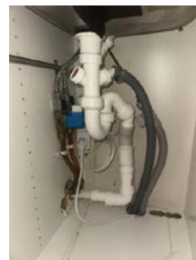
Røropplegg i kjøkkenbenk med Waterguard
