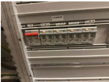
Sikringsskap med automatsikringer.
