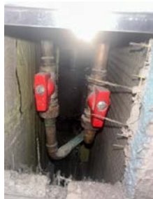
Stoppekraner plassert i luke på bad
