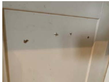
En front med fuktsvelling skade
