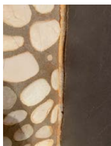
Fuge i overgang gulv og vegg har glippe
