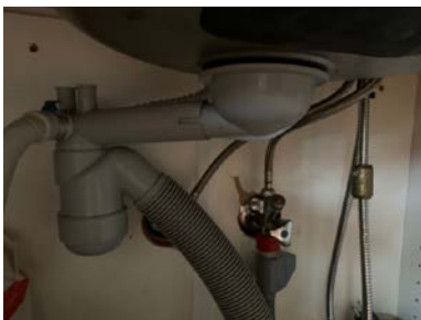
Rørplegget i kjøkken
