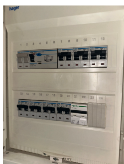
Sikringsskap med automatsikringer.
