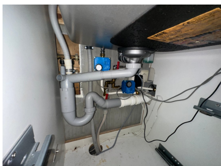
Røropplegg i kjøkkenbenk med Waterguard
