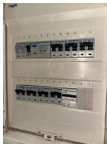
Sikringsskap med automatsikringer.
