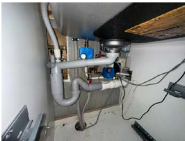
Rørøpplagg i kjøkkenbenk med Waterguard
