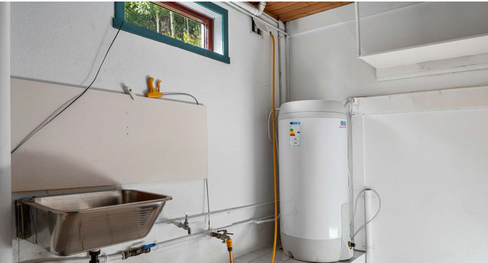
At boligen har et separat vaskerom er et ekstra pluss. Her står det en 200 liters varmtvannsbereider fra 2021.
