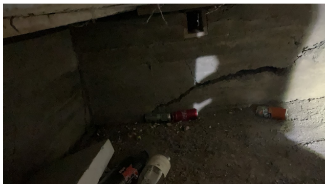
Store sprekker og setningskader registrert fra luke i gulv
