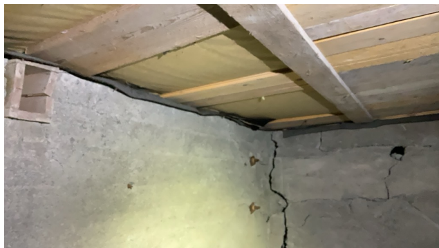
Sprekker i mur
