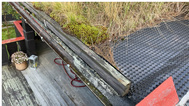
Slitasje av tak
