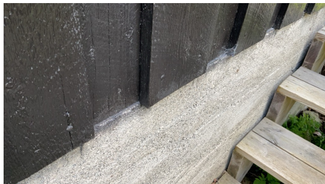
Underligger ligger nedpå grunnmur og fare for oppfukning der glippe eller tiltak bør foretas
