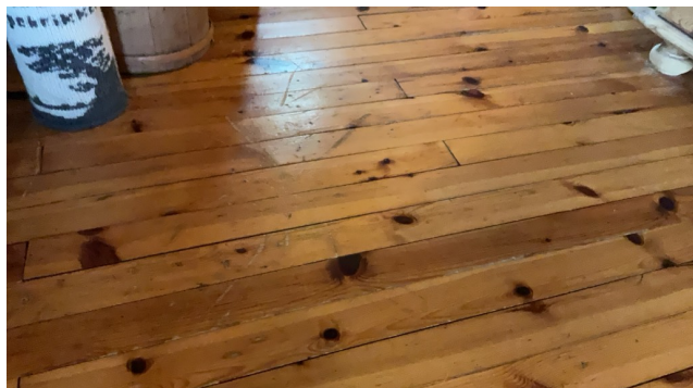
Slitasje på gulvoverflate
