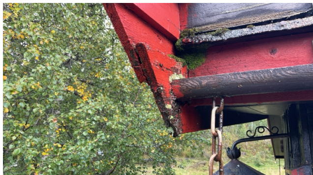
Slitasje med råte i ende av vindskie
