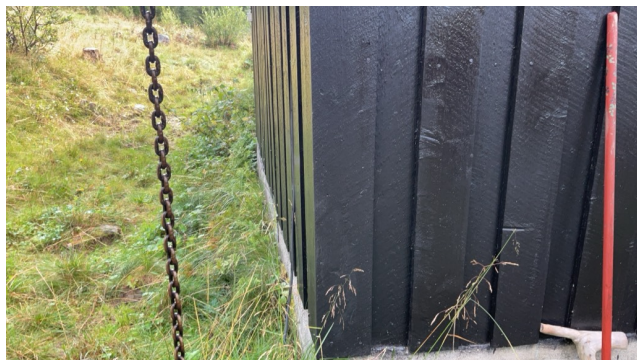
Skjevheter i yttervegg og veggkonstruksjoner
