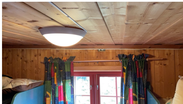
Store skjevheter/setningskader i bygning
