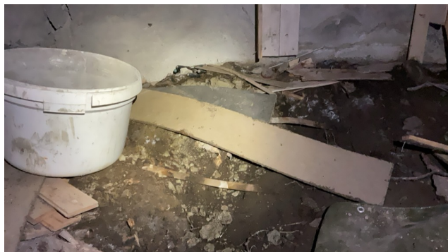
Manglende dampsperre på grunn av jordmasse
