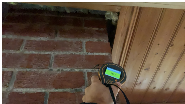
Fukt/rennermerker på pipestamme, ved fuktmåletaking var det fuktskjolder og anbefaler nærmere undersøkelse og tiltak for å unngå videre skadeutvikling.
