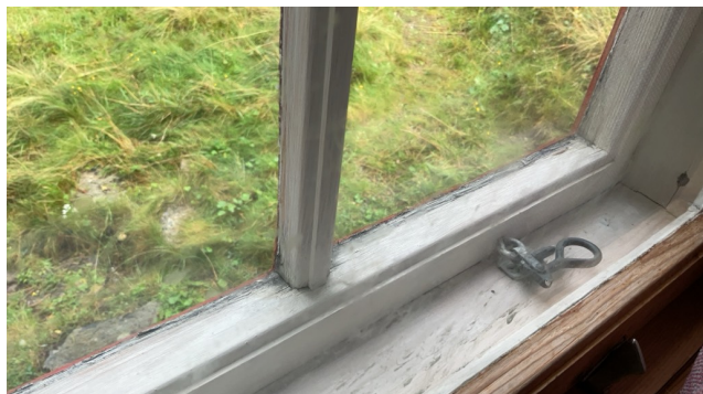
Slitasje på vinduer
