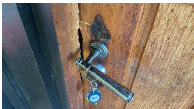
Skade på dørblad og karm
