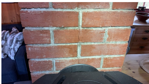
Sprekk i pipe
