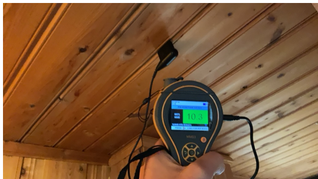
Fuktskjolder ved himling, ved fuktmåletaking var det ikke fuktutslag
