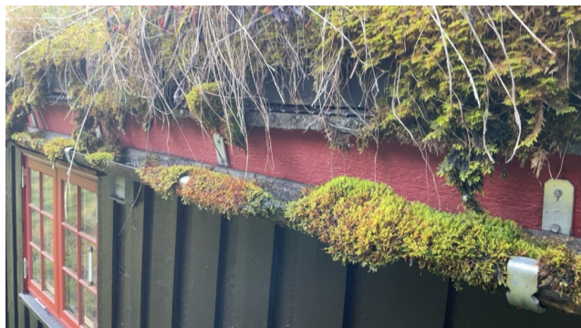
Manglende forkantbeslag, takvann fører til oppfukning ved takfot
