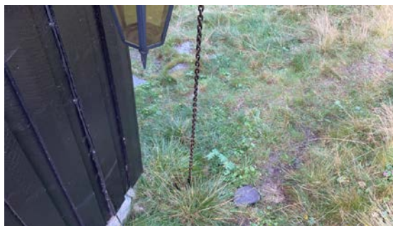
Manglende bortledning av takvann, anbefales føres vekk fra bygningskropp
