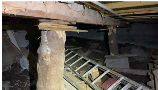
Enkel oppstøtning utsatt for fuktpåvirkning og bevegelser i grunn med skjevhet
