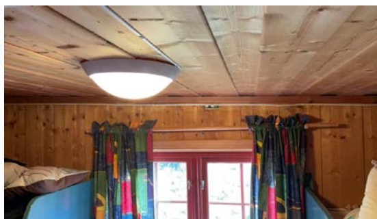
Store skjevheter/setningskader i bygning
