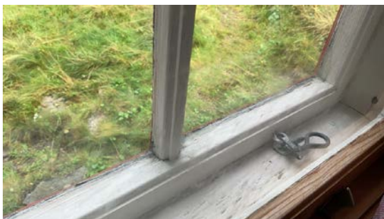
Slitasje på vinduer
