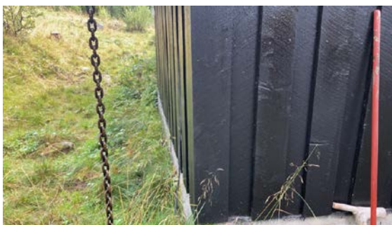
Skjevheter i yttervegg og veggkonstruksjoner
