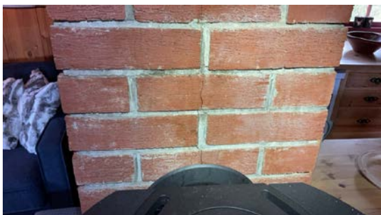
Sprekk i pipe
