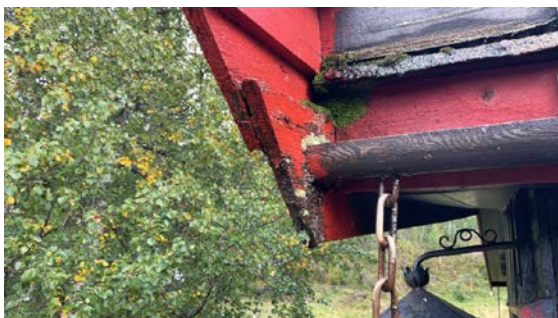
Slitasje med råte i ende av vindskie
