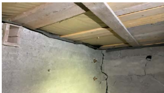
Sprekker i mur
