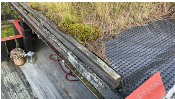
Slitasje av tak
