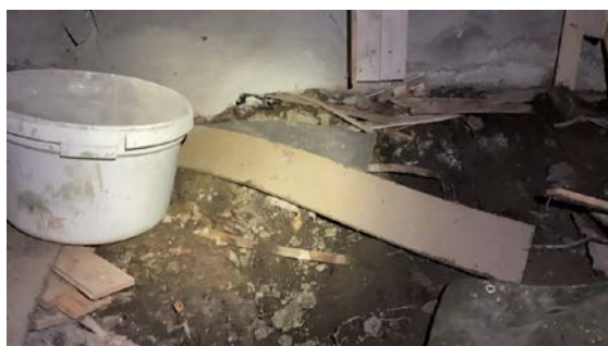
Manglende dampsperre på grunn av jordmasse
