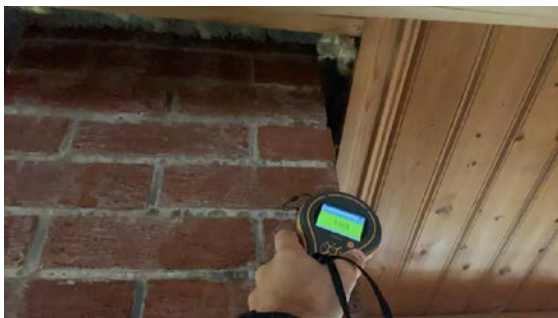
Fukt/rennemerker på pipestamme, ved fuktmåletaking var det fuktskjolder og anbefaler nærmere undersøkelse og tiltak for å unngå videre skadeutvikling.
