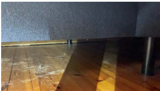
Glippe mellom gulv/gulvlist som følge av setningsskader i bygning
