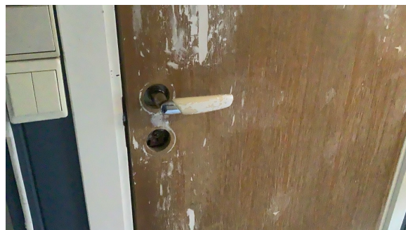
Manglende skilt rundt vrider og låseskilt, og utilfredsstillende utseende på dørblad.
