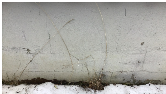
Horisontale og vertikale riss i ringmur.
