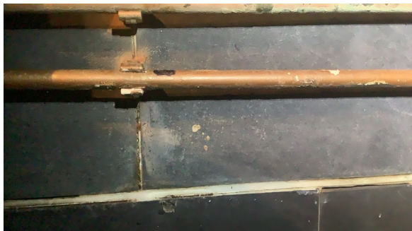
Utett plateskjøt i dusjen.
