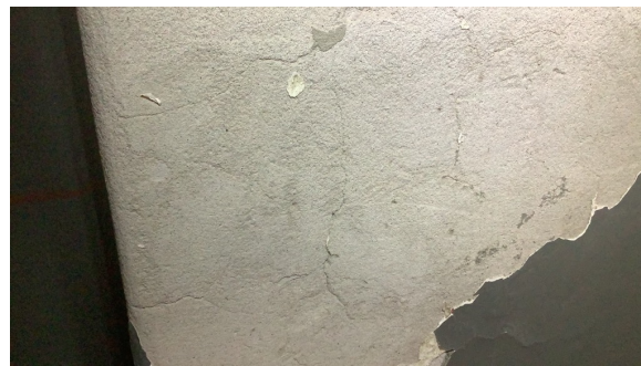
Riss i puss på pipe.
