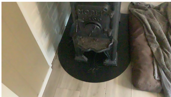
Mangelfull størrelse på ildfast plate under ildsted.
