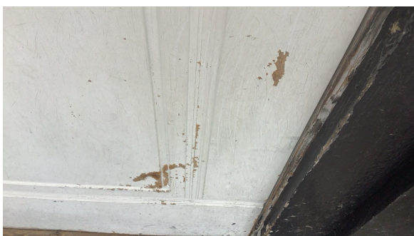
Skader og slitasje i ytterdør.
