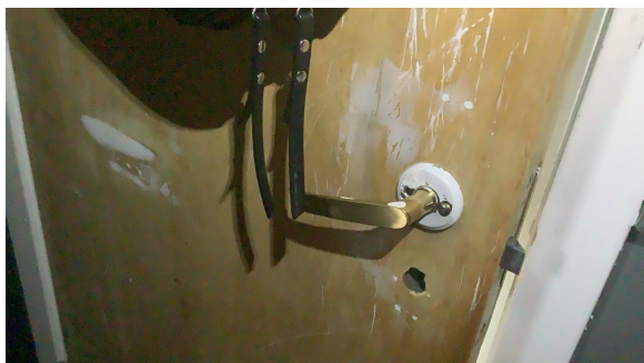
Manglende låseskilt og utilfredsstillende utseende på dørblad.
