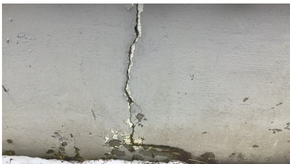
Sprekkdannelse i ringmur.
