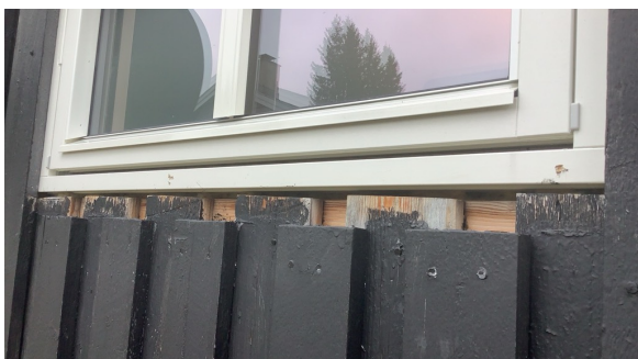
Vindu mangler vannbrett i bunnen.
