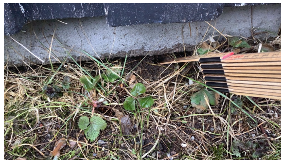
Masser har sunket, så ringmur henger fritt under tilbygg.
