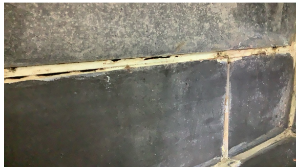
Utett silikonfuge mellom platebunn og sokkellist i dusjen.
