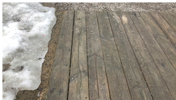
Terrassebord har løsnet og vridd seg.
