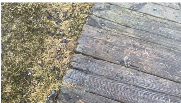
Skader og slitasje i ender av terrassegulv.
