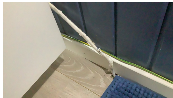
Eksempel på løs kabel.
