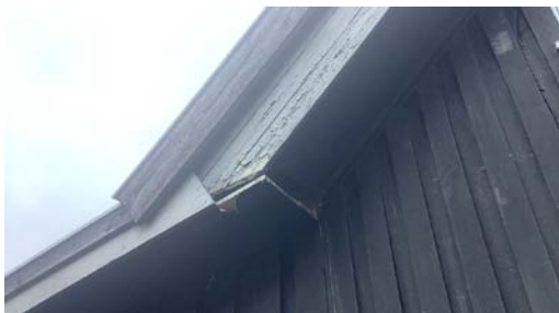
Eksempel på værslitt vindski, og avslutning av vindskier er ikke ferdigstilt.
