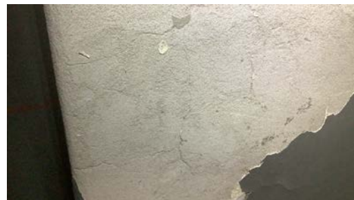
Riss i puss på pipe.
