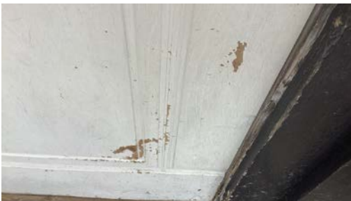
Skader og slitasje i ytterdør.
