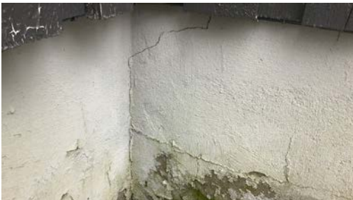
Skråriss i ringmur.
