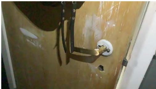
Manglende låseskilt og utilfredsstillende utseende på dørblad.
