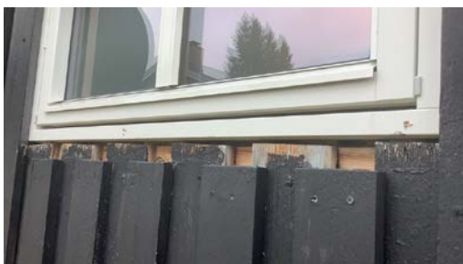
Vindu mangler vannbrett i bunnen.
