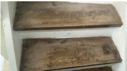
Slitasje i trinn.
