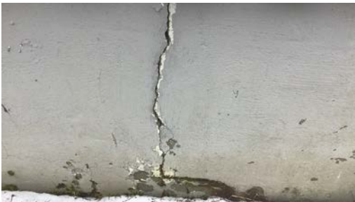
Sprekkdannelse i ringmur.
