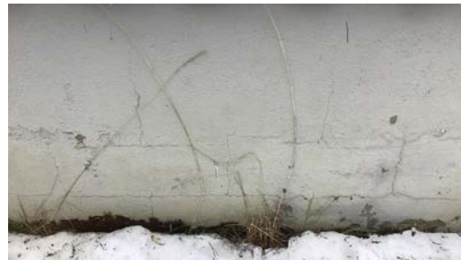
Horisontale og vertikale riss i ringmur.
