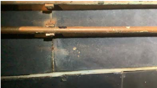
Utett plateskjøt i dusjen.
