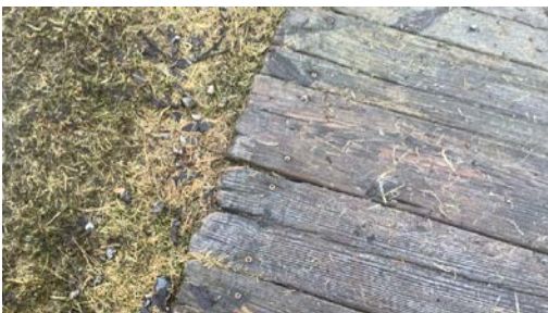
Skader og slitasje i ender av terrassegulv.
