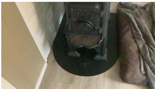
Mangelfull størrelse på ildfast plate under ildsted.
