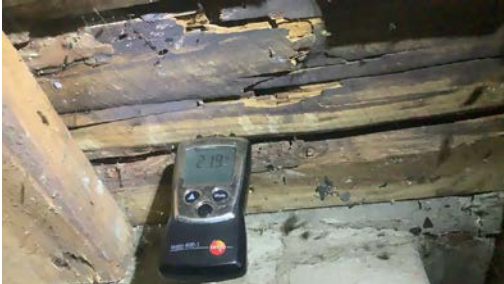
Skadelig fuktinnhold, og råteskader i stubbeloftsbord.
