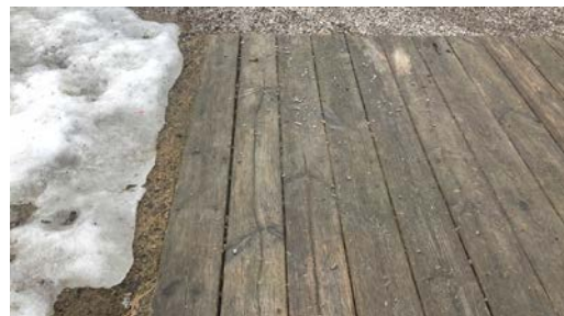
Terrassebord har løsnet og vridd seg.
