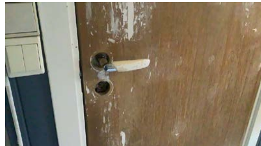
Manglende skilt rundt vrider og låseskilt, og utilfredsstillende utseende på dørblad.
