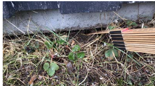
Masser har sunket, så ringmur henger fritt under tilbygg.
