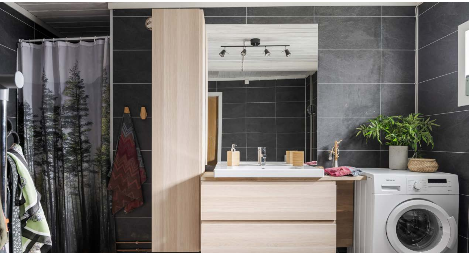
Dusj med forheng og opplegg til vaskemaskin i rommet. Det er lagt opp badekarbatteri på vegg og avløp i gulv.
