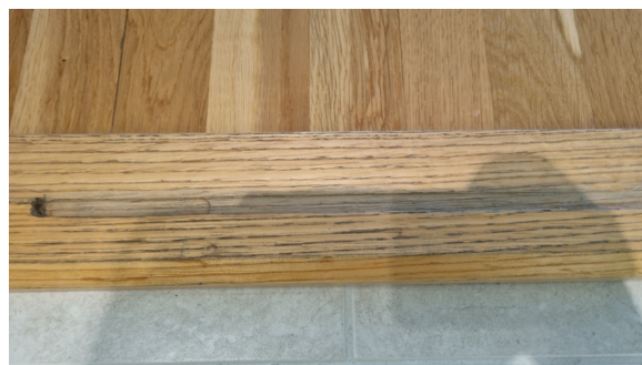
Luftespalte i dørterskel.
