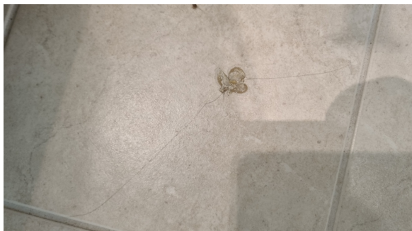
Det er påvist sprekker i flis.
