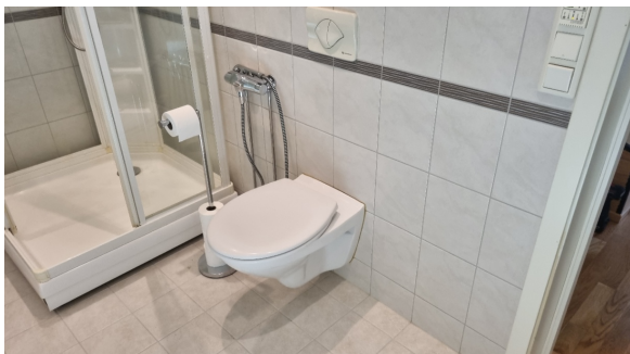
Manglende drensåpning under den innebygde sisternen.
