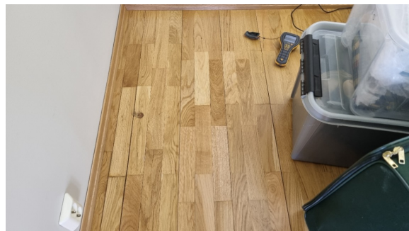
Det er registrert fuktmerker i gulvet i boden, i den delen hvor den innebygde sisternen er plassert.
