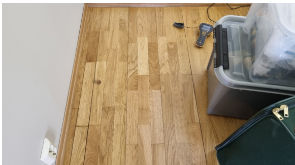
Fuktsvell i parkett.
