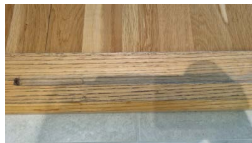
Luftespalte i dørterskel.
