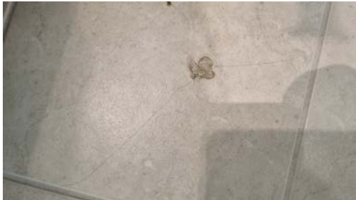
Det er påvist sprekker i flis.
