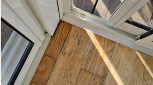
Fuktmerker i parkett.
