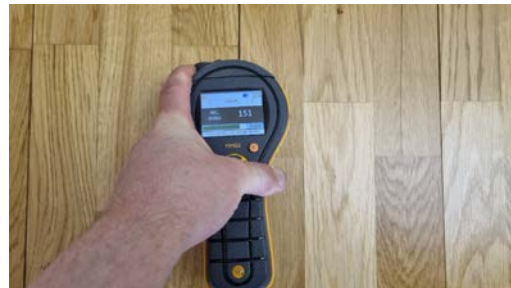
Det ble ikke registrert forhøyde fuktverdier ved befang.
