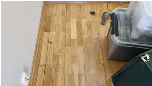
Fuktsvell i parkett.
