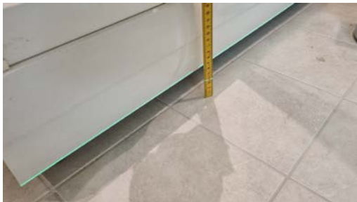
Gulvet har svakt fall til sluk.
