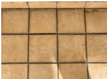
Løse fuger og fliser.
