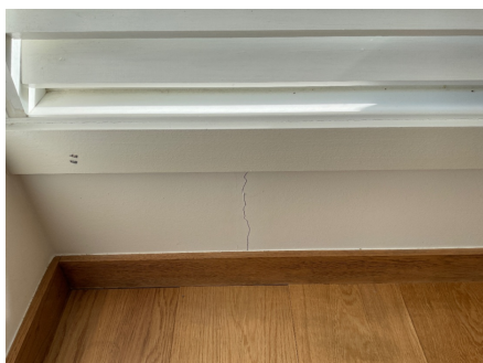
Sprekker på vegger.
