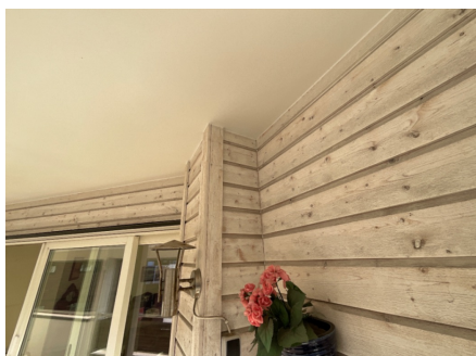
Kledning bør vaskes og males.
