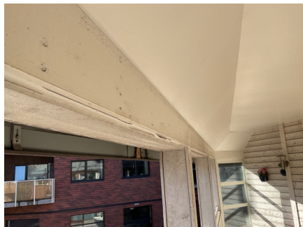
Vegger med manglende vedlikehold.
