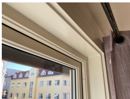
Sprekker mellom foring og list
