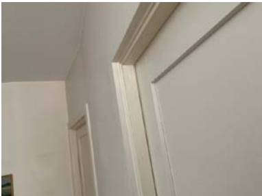
Dør som slår ujevnt mot karm.
