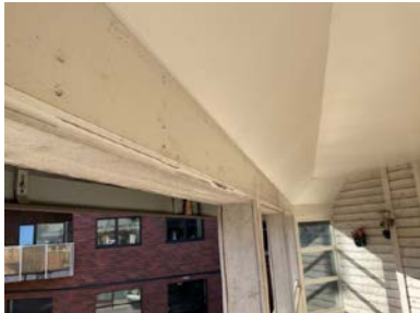
Vegger med manglende vedlikehold.
