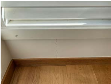
Sprekker på vegger.
