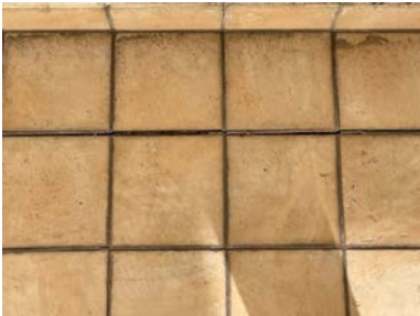
Løse fuger og fliser.
