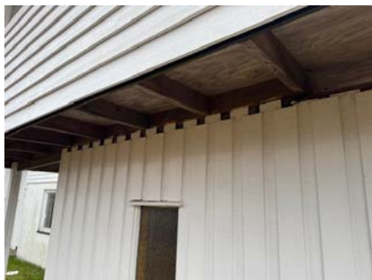
noe gjenstående arbeider
