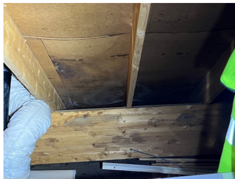
Kondens merker i undertak.
