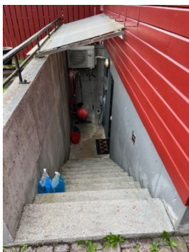
Kjellertrapp mangler håndløper på vegg.
