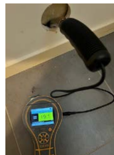
Fuktmåling i påforet grunnmur som vender mot terreng.
