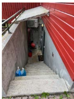
Kjellertrapp mangler håndløper på vegg.
