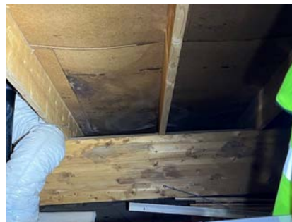
Kondens merker i undertak.
