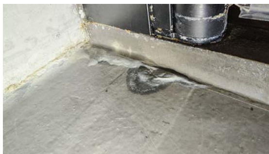
Det må gjøres nærmere undersøkelser. Det ligger igjen ansamling av fuktighet og tettesjikt ser svekket ut.
