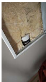
Vakuumbeskyttelse tilgjengelig i luke 2.etg.
