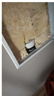
Vakuumbeskyttelse tilgjengelig i luke 2.etg.
