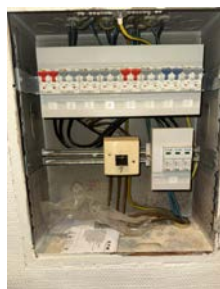
Sikringskap med automatsikringer.
