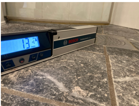
Fall ved dusjsone
