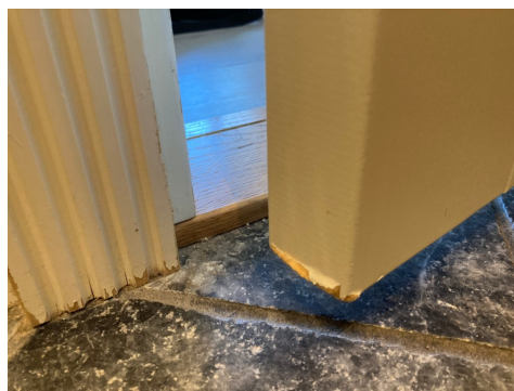
Skade i nedre kant av dør
