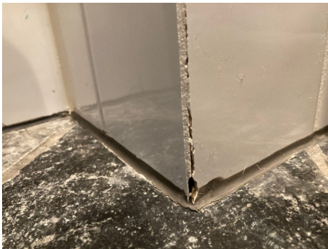
Skade i fliser, hjørne
