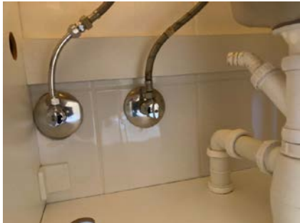
Røropplegg i skap under vask
