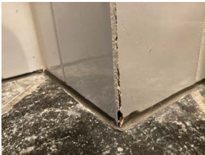
Skade i fliser, hjørne
