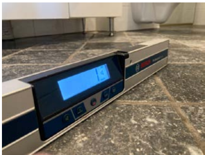
Fall golv utenfor dusjsone
