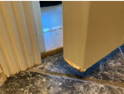
Skade i nedre kant av dør
