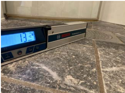
Fall ved dusjsone
