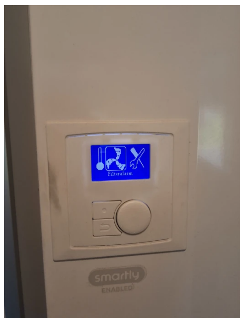
Det registreres aktiv filteralarm på anlegget.
