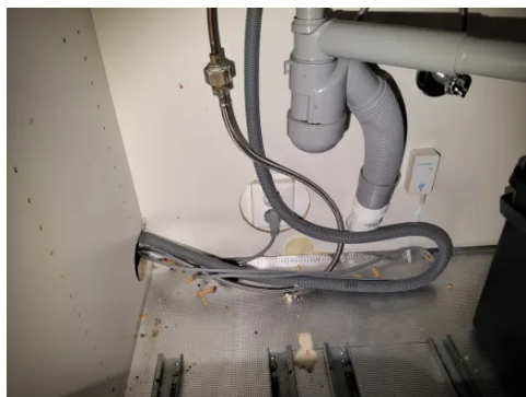
Leiligheten har synlige avløpsrør av plast.
