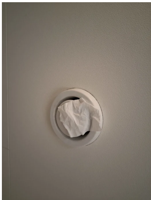
Avtrekkseffekten er testet med papir.
