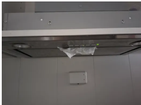
Avtrekkseffekten er testet med papir.
