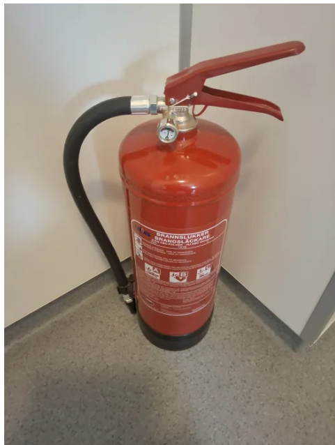
Brannslukningsapparat er plassert på bod/teknisk rom.
