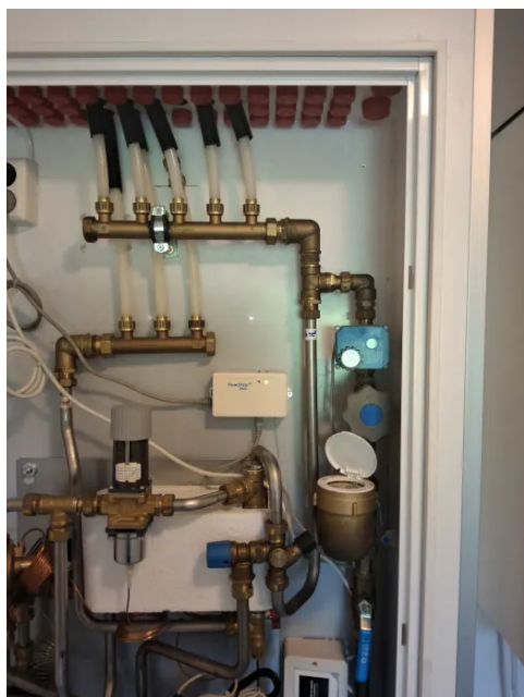
Hovedstoppekran er plassert i skap på teknisk rom.
