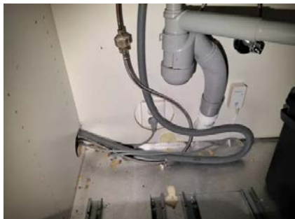
Leiligheten har synlige avløpsrør av plast.
