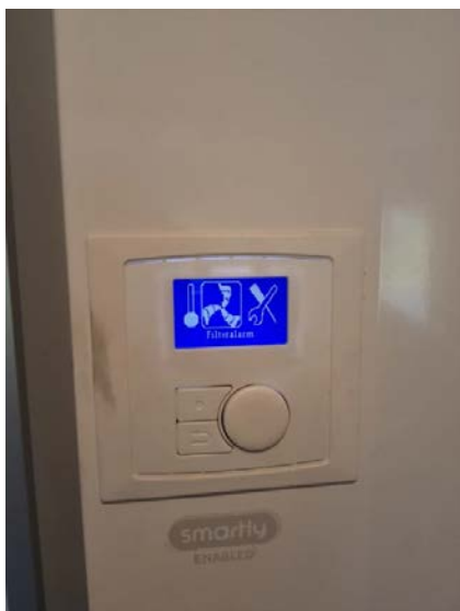
Det registreres aktiv filteralarm på anlegget.
