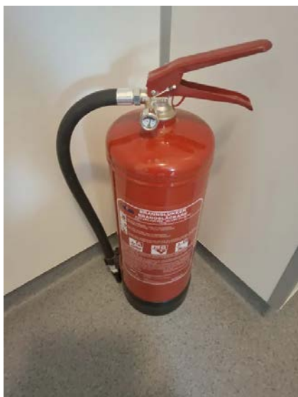
Brannslukningsapparat er plassert på bod/teknisk rom.
