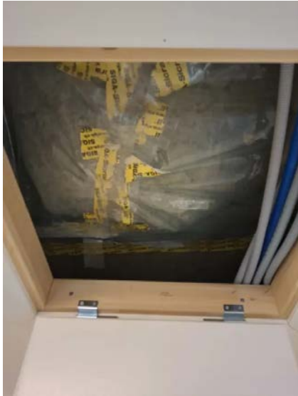
Inspeksjonsluke er plassert i gang.
