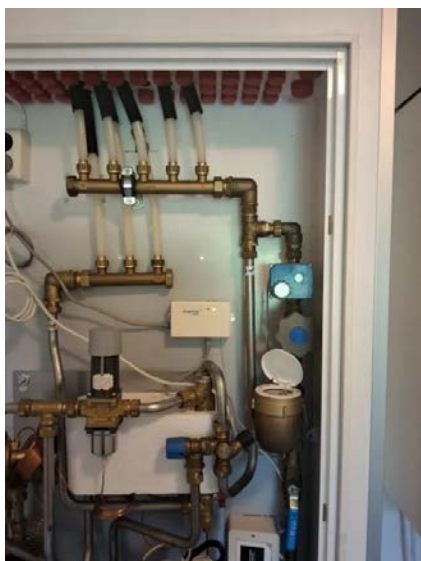
Hovedstoppekrane er plassert i skap på teknisk rom.
