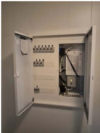
Sikringsskap er plassert i entré.
