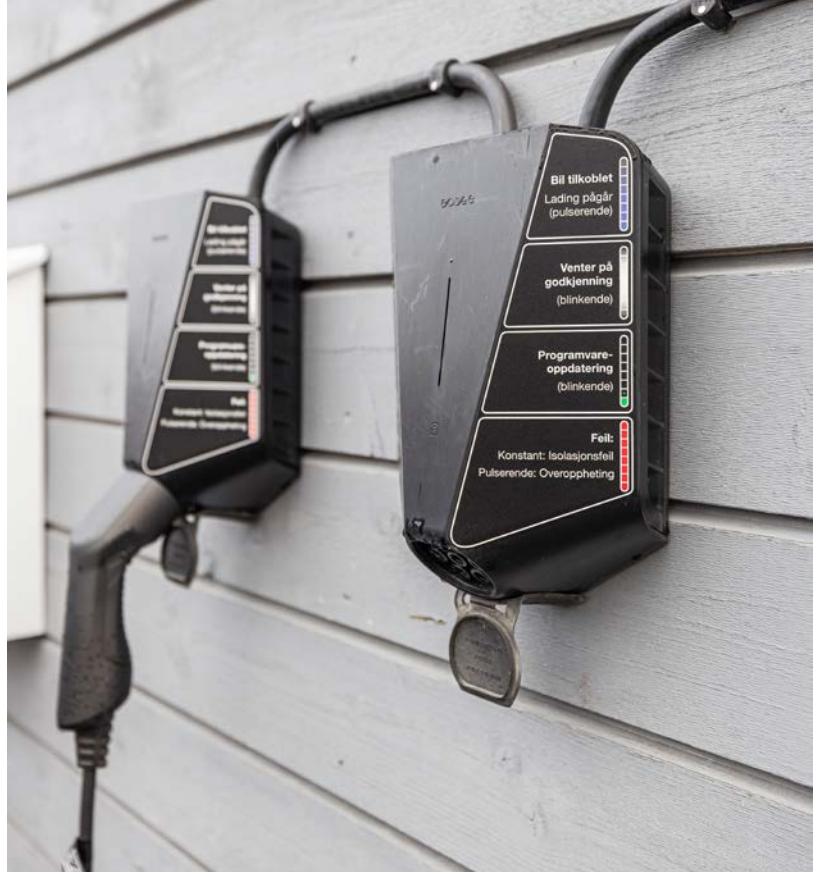
Sameiet har to elbil-ladere til felles bruk.
