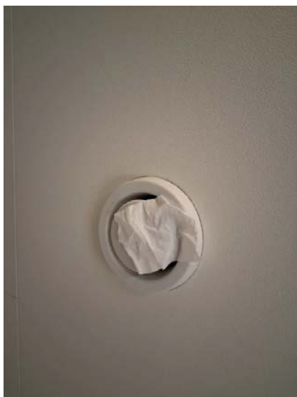
Avtrekkseffekten er testet med papir.
