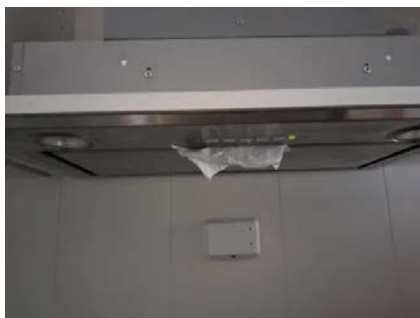
Avtrekkseffekten er testet med papir.
