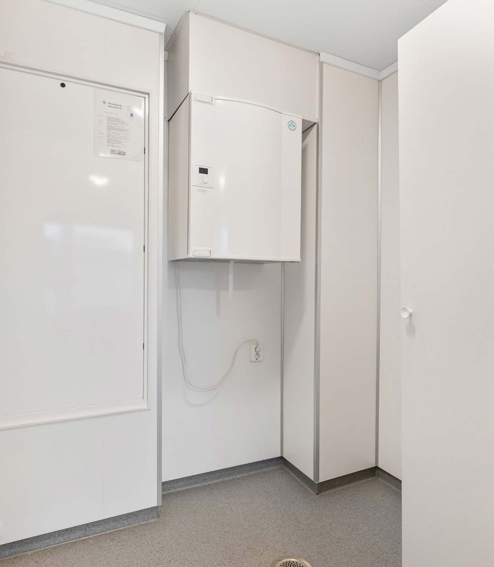
Bod/teknisk rom med adkomst fra det tredje soverommet.
