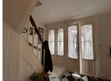
Dørblad er vindskjevt, hall med trapp.
