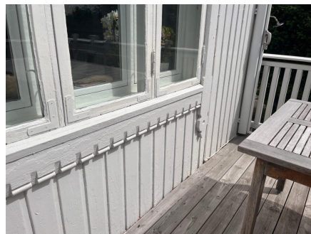
Vannbrett montert uten spalte mot karm.
