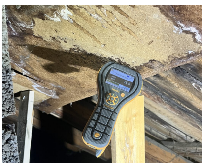
Nedenfor pipe av leca
