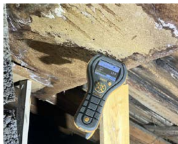
Nedenfor pipe av leca
