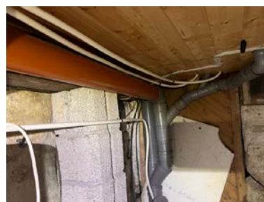
Rør er dårlig festet på deler av anlegget.
