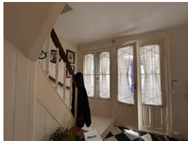
Dørblad er vindskjevt, hall med trapp.
