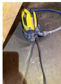
Pumpe er plassert i kjeller under innglasset balkong.
