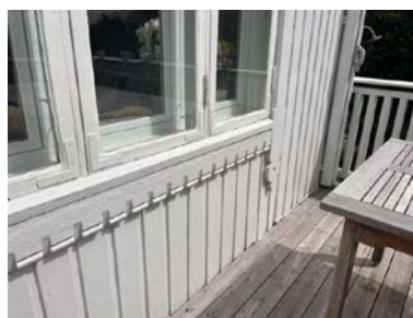
Vannbrett montert uten spalte mot karm.
