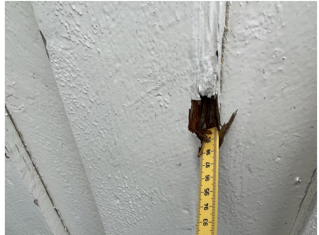
Det er punktvis råteskader på kledning.
