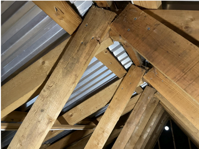
Svak dimensjonering i bærende konstruksjon.
