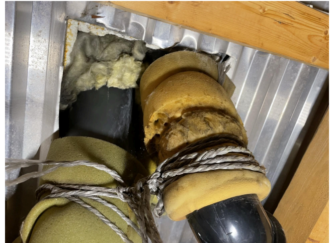
Feil utførelse av gjennomføringer.
