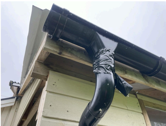
Skjøter teipet. Manglende endelukk.
