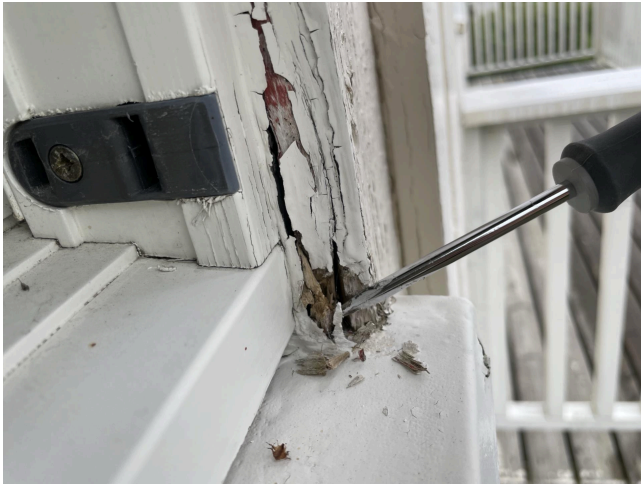
Dårlig detaljløsning rundt vindu, med manglende klaring mellom kledning og vannbrett.
