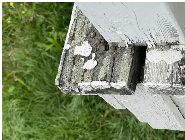
Slitasje på overflatebehandling (maling/beis). Begynnende råte i bjelkelag eller dekke.
