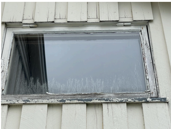
Det er avflassing av maling/ beis p  vindu.
