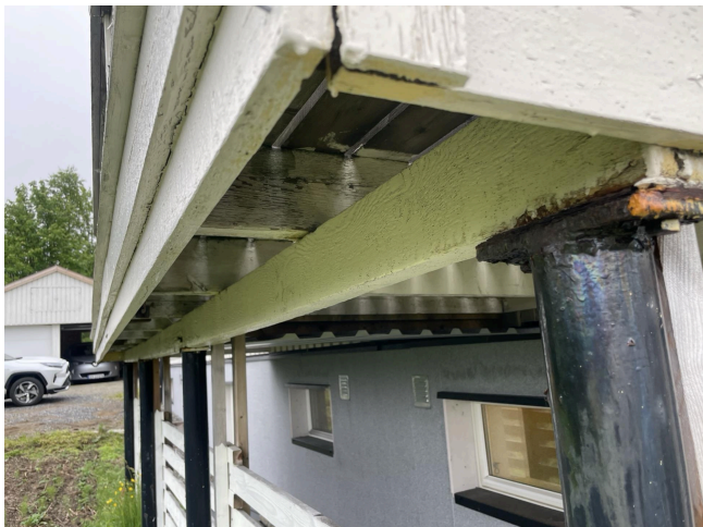
Konstruksjonene er for dårlig dimensjonert.
