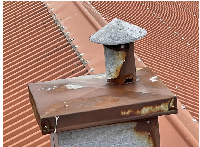
Luftehatt for ventilasjon og avløp er rustet og har hull.
