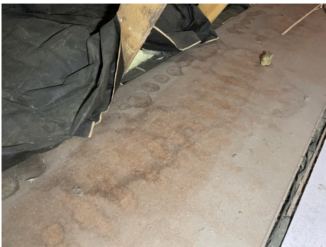
Fuktskjolder på golvplater.
