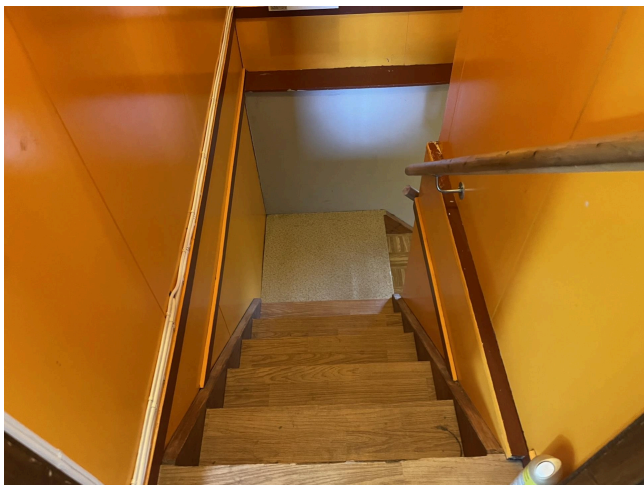
Manglende håndlister på vegg.
