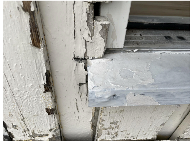
Beslag under vindu mangler oppbrett.
