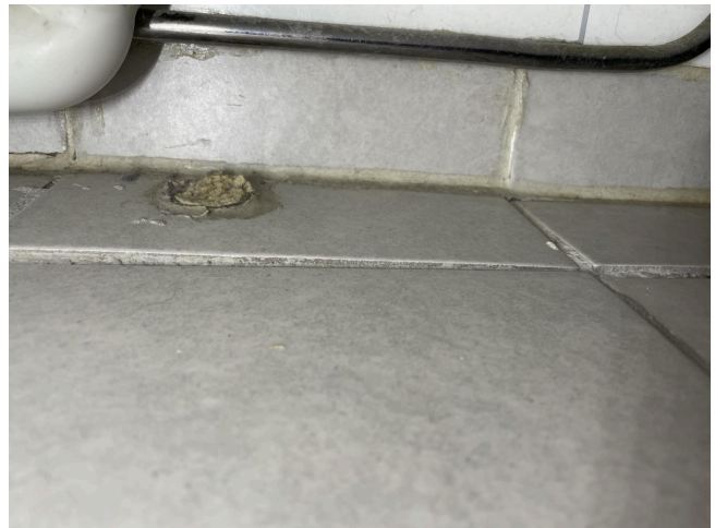
Hull i gulvflis er tettet med fugemasse.
