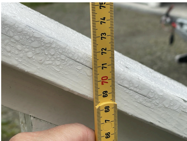
Rekkverk i trapp er ikke i henhold til krav.
