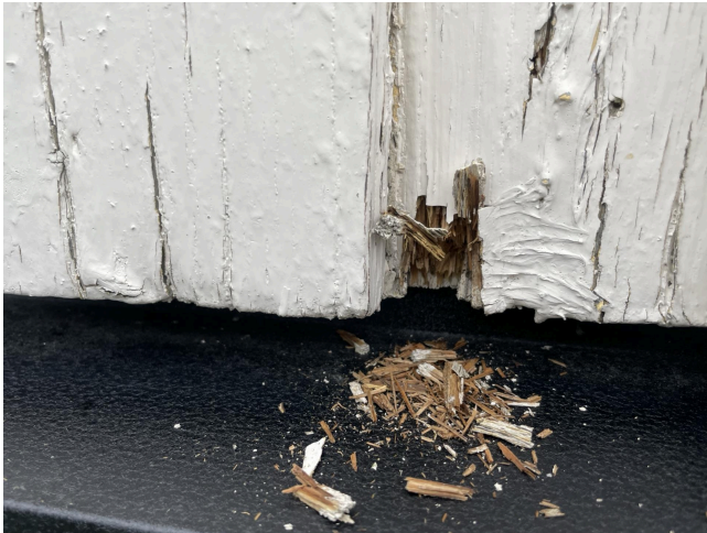
Det er punktvis råteskader på kledning.
