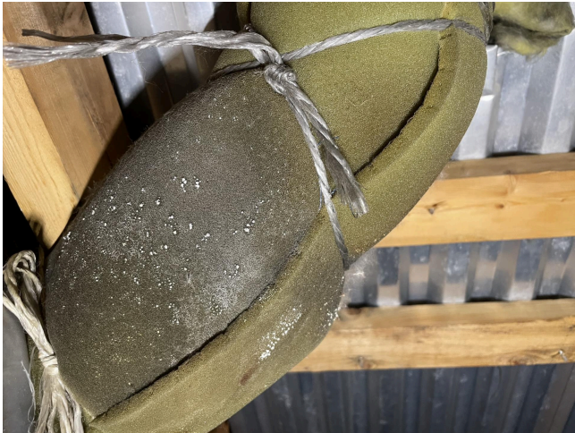
Feil isolering av pvc rør på kaldloft.
