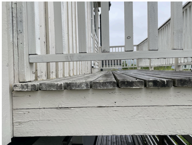
Slitasje på overflatebehandling (maling/beis).
