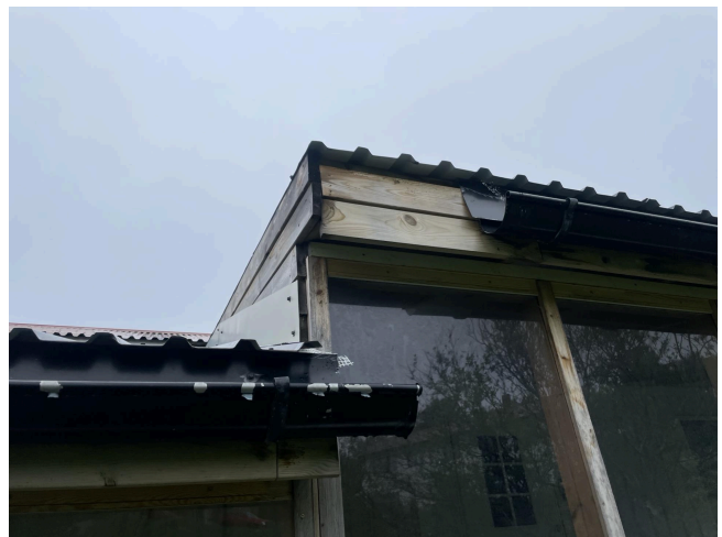
Manglende endelukk. Manglende takfotbeslag.
