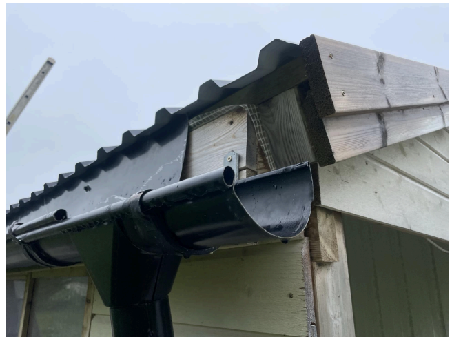
Manglende endelukk. Manglende takfotbeslag.
