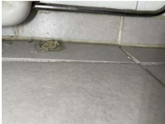
Hull i gulvflis er tettet med fugemasse.
