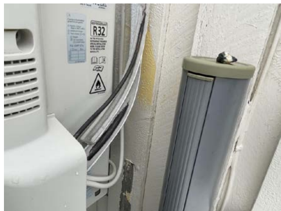
Det er skade på kondensisasjonen til rørføringer fra luft-til-luft varmepumpen.
