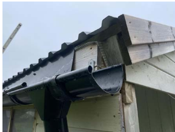
Manglende endelokk. Manglende takfotbeslag.
