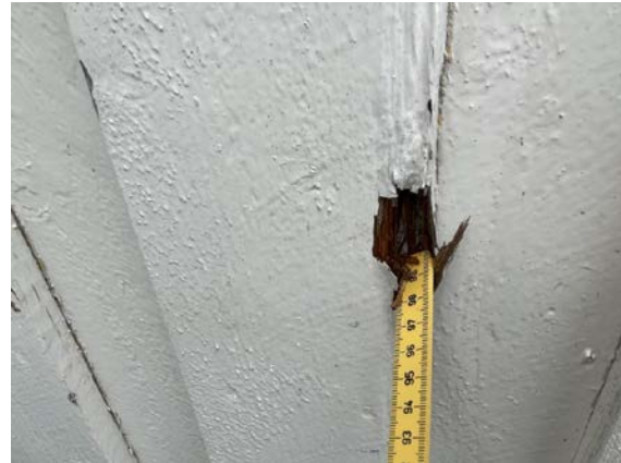
Det er punktvis råteskader på kledning.
