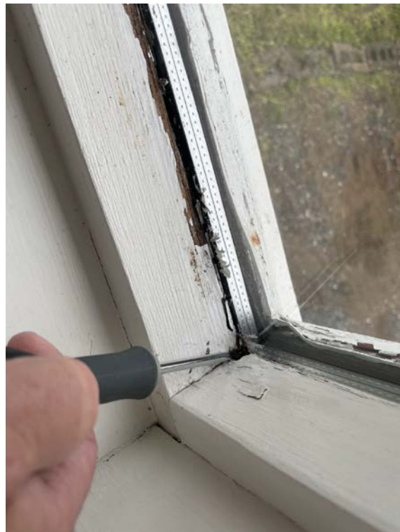
Det er råte i karm eller ramme vindu.
