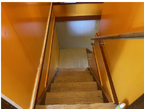
Manglende håndlister på vegg.
