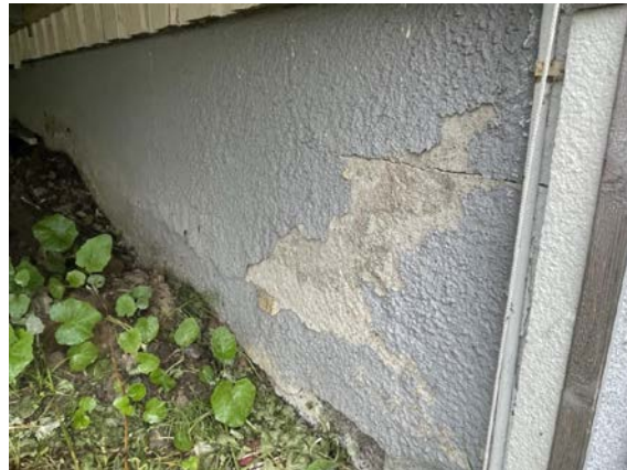
Det er setningskader. Det er avflassing og riss i pussoverflaten til mur. Det er manglende grunnmursplate for vanntrykk på konstruksjoner mot terreng.
