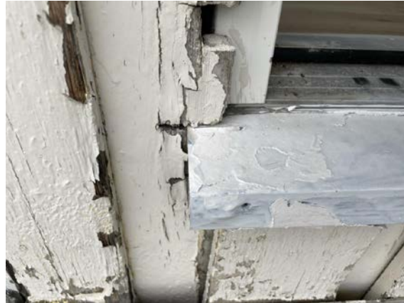
Beslag under vindu mangler oppbrett.
