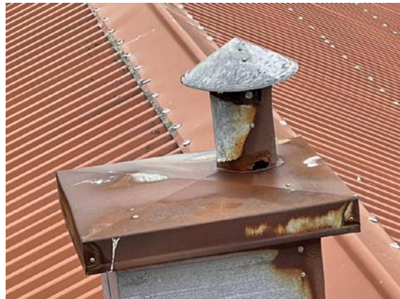
Luffehatt for ventilasjon og avløp er rustet og har hull.
