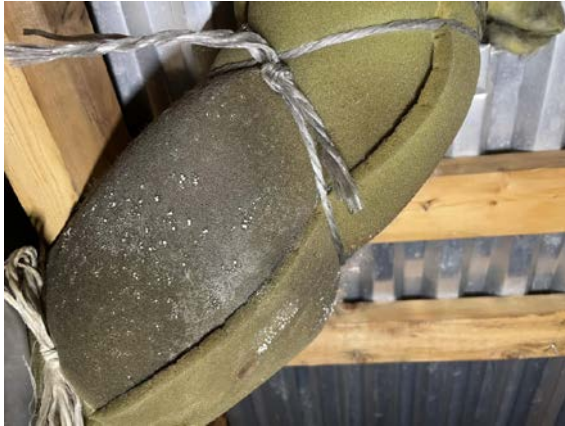
Feil isolering av pvc rør på kaldloft.
