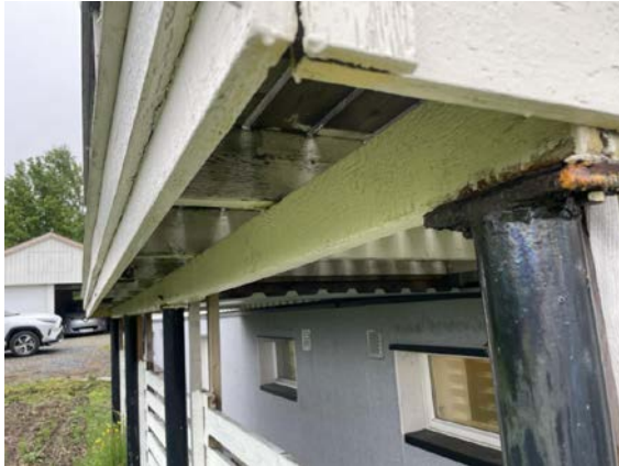
Konstruksjonene er for dårlig dimensjonert.
