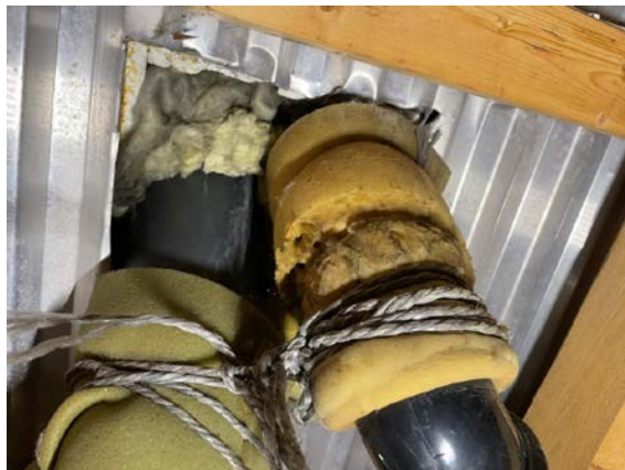
Feil utførelse av gjennomføringer.
