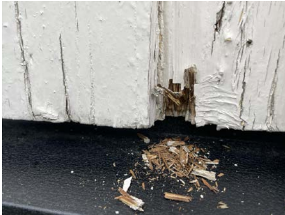
Det er punktvis råteskader på kledning.
