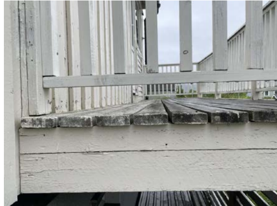
Slitasje på overflatebehandling (maling/beis).
