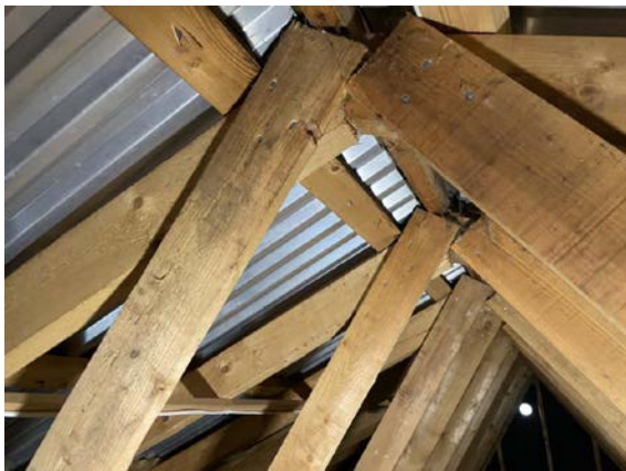
Svak dimensjonering i bærende konstruksjon.
