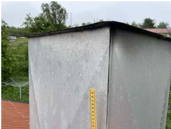
Pipe mangler pipehatt. Det er ikke montert plattform for feier. Kortside av pipe er over 1,2 meter uten tilfredsstillende adkomst.
