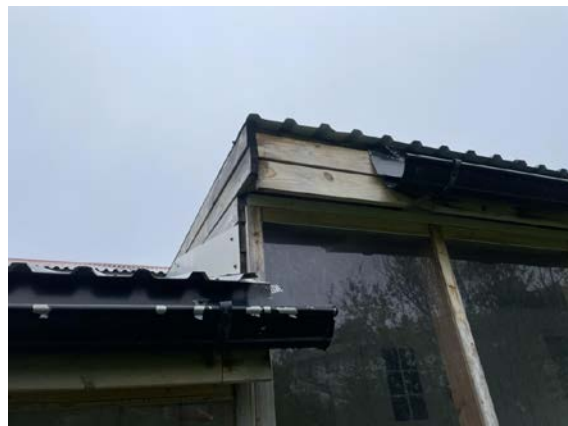
Manglende endelokk. Manglende takfotbeslag.
