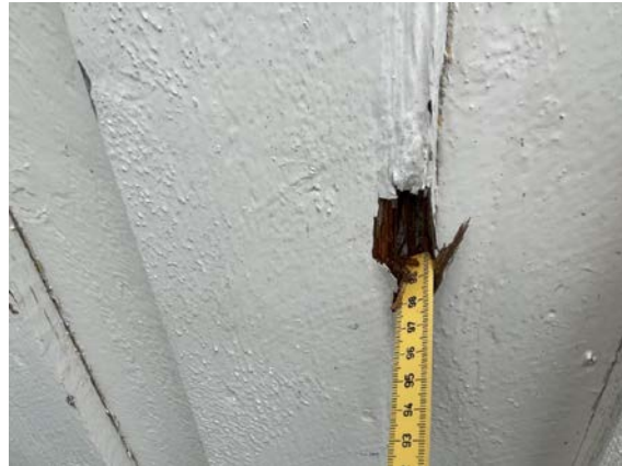
Det er punktvis råteskader på kledning.
