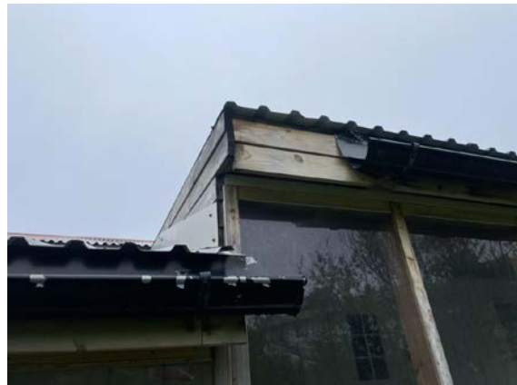
Manglende endelokk. Manglende takfotbeslag.
