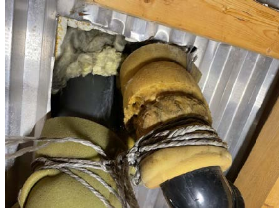
Feil utførelse av gjennomføringer.
