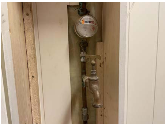
Det er registrert irr på kobberør. Vannkran er montert før vannmåler, noe som ikke er i henhold til dagens krav.
