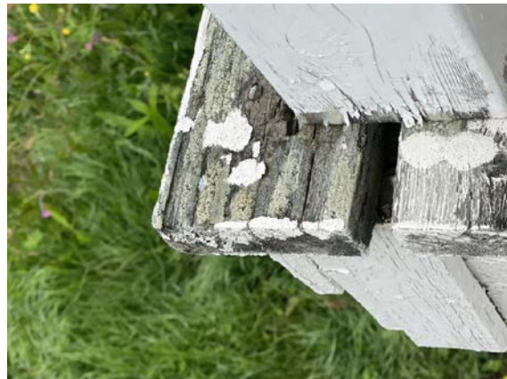
Slitasje på overflatebehandling (maling/beis). Begynnende røte i bjelkelag eller dekke.
