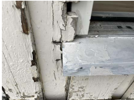
Beslag under vindu mangler oppbrett.
