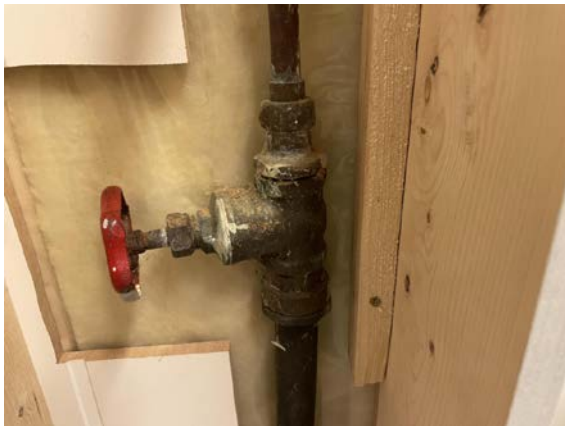
Eldre stoppekran med skrukobling er registrert.
