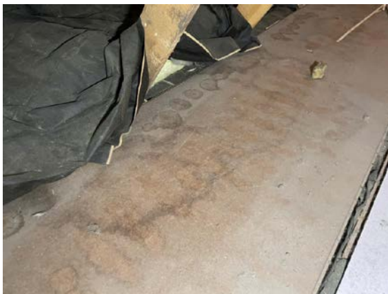
Fuktskjolder på golvplater.
