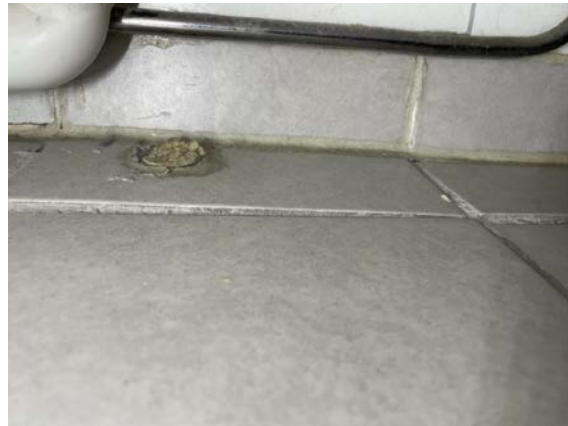
Hull i gulvflis er tettet med fugemasse.
