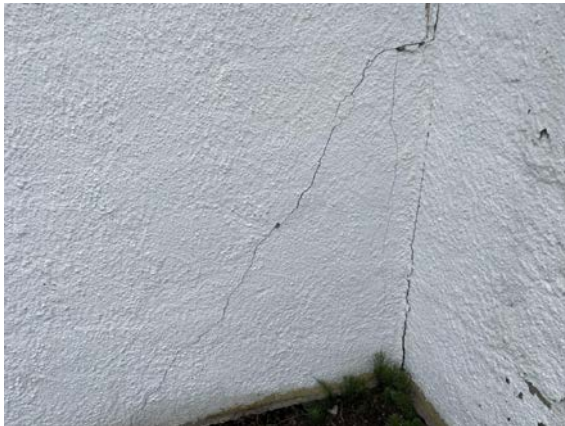
Det er setningskader. Det er manglende grunnmursplate for vanntrykk på konstruksjoner mot terreng.
