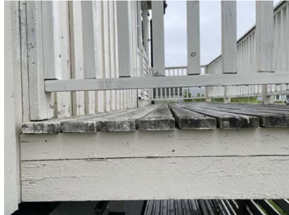
Slitasje på overflatebehandling (maling/beis).
