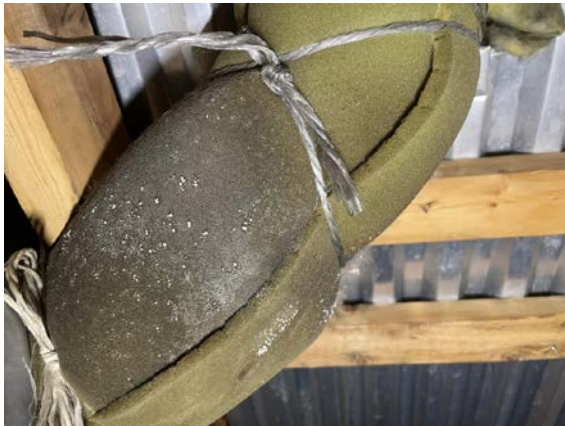
Feil isolering av pvc rør på kaldloft.
