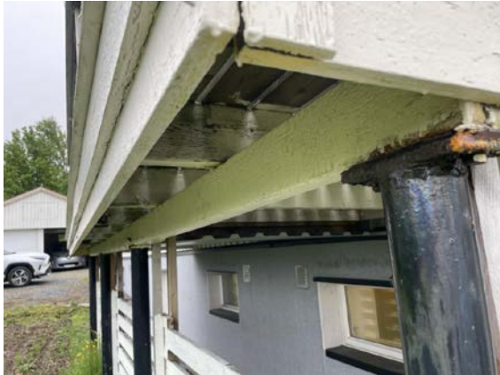
Konstruksjonene er for dårlig dimensjonert.
