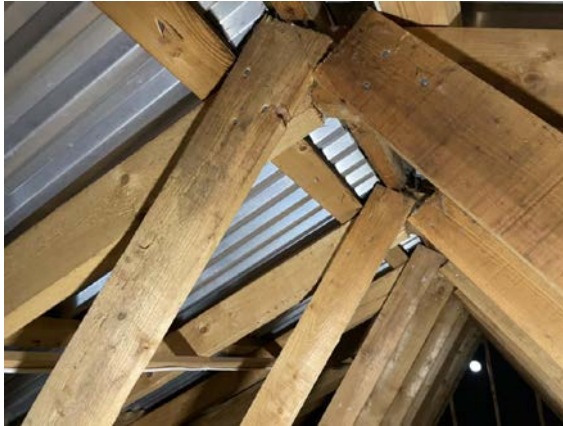
Svak dimensjonering i bærende konstruksjon.
