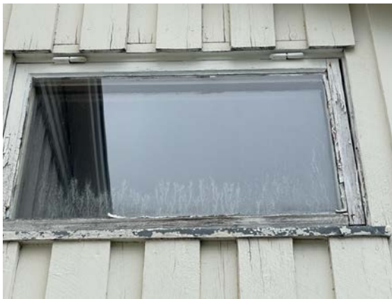
Det er avflassing av maling/ beis på vindu.
