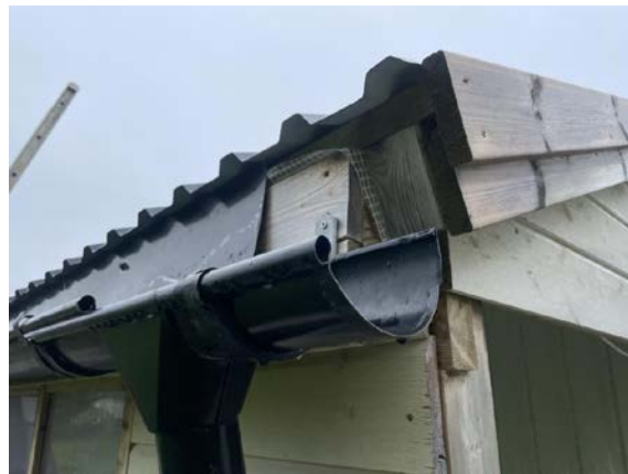
Manglende endelokk. Manglende takfotbeslag.
