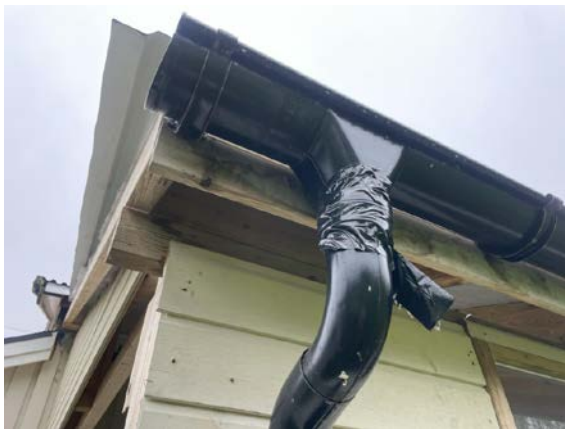
Skjører teipet. Manglende endelokk.
