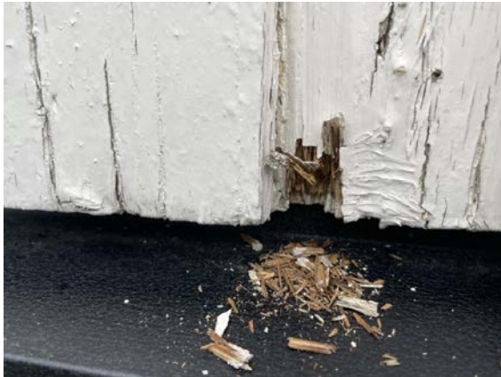
Det er punktvis råteskader på kledning.
