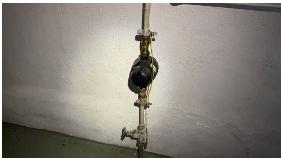
Stoppekran plassert i kjeller.
