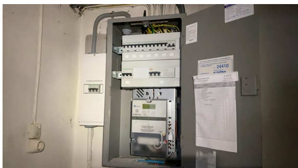
Sikringsskap plassert i kjeller.
