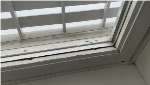
Sprekk i vindu på soverom.
