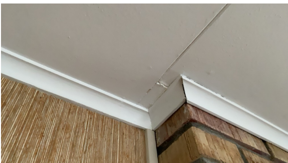
Fuktmerker rundt pipe.
