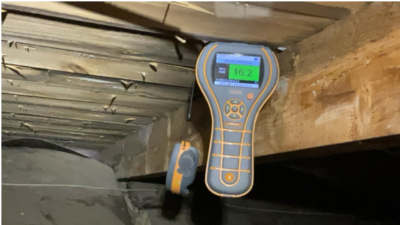
Ved fuktmåling registrerte jeg risikable verdier for fukt
