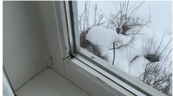
Kondensmerker på flere vinduer
