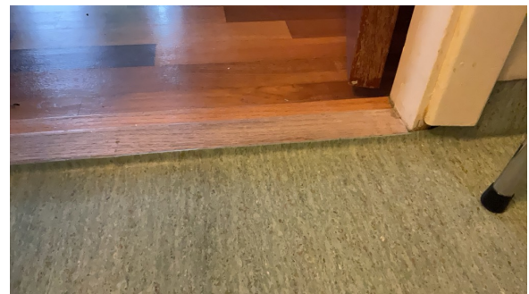
Målt oppbrett ved terskel: 10mm.
