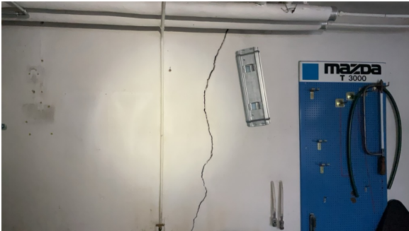
Sprekker i vegger.
