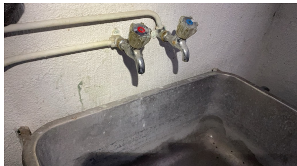
Kran i vaskekjeller drypper.
