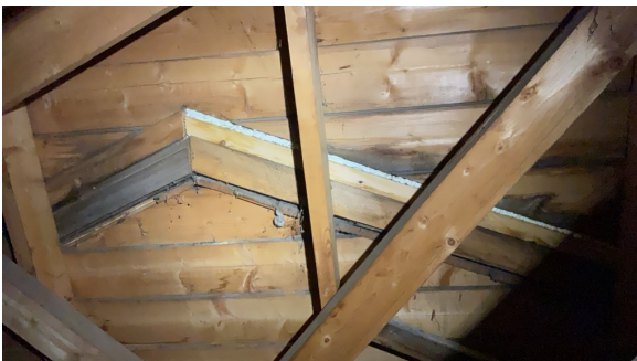
Fuktmerker på innsiden av kledning på område som er over garasjetak.
