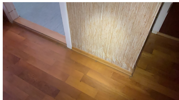
Slitasje på overflater
