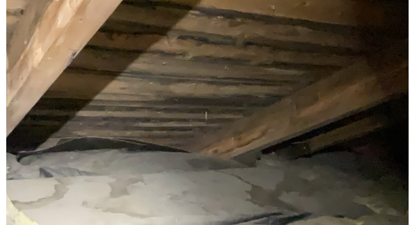
Kondens/fuktmerker flere steder på undertaket.
