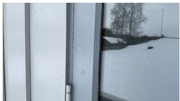
Bobler i maling på terrassedør soverom.
