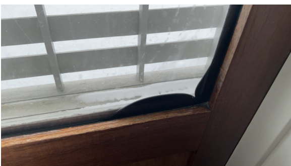
Sprekk i rute på soverom.
