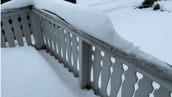
Slitasje på håndløper.
