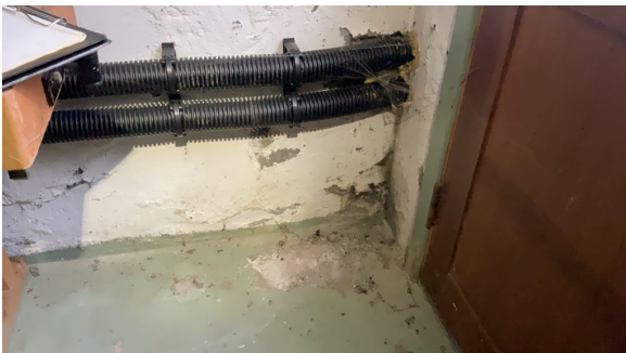
Saltutslag og fuktvandring registrert i vegger.
