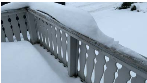
Slitasje på håndløper.
