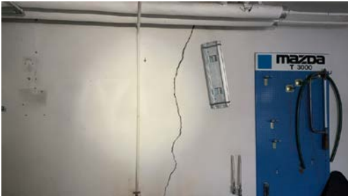
Sprekker i vegger.
