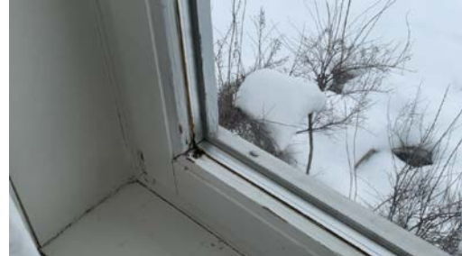
Kondensmerker på flere vinduer
