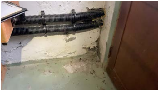
Saltutslag og fuktvandring registrert i vegger.
