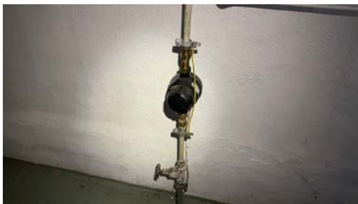
Stoppekran plassert i kjeller.
