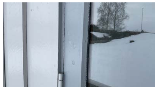
Bobler i maling på terrassedør soverom.
