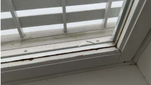
Sprekk i vindu på soverom.
