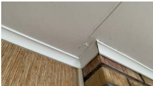
Fuktmerker rundt pipe.
