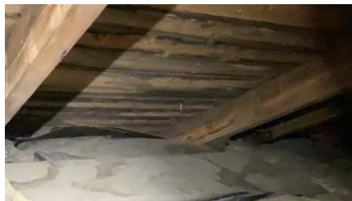
Kondens/fuktmerker flere steder på undertaket.
