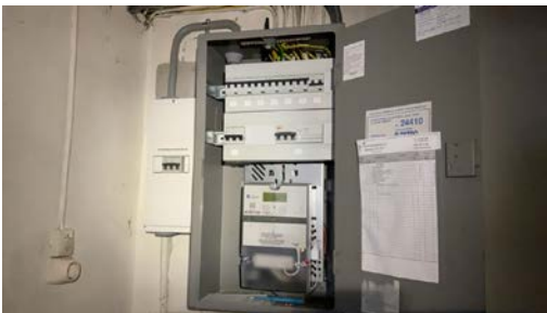
Sikringsskap plassert i kjeller.
