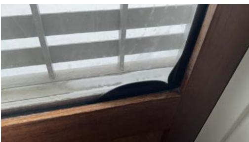
Sprekk i rute på soverom.
