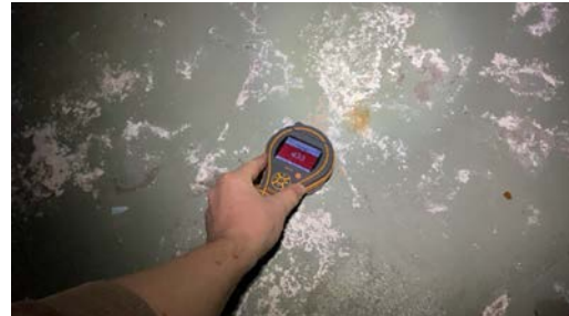
Ved enkle fuktsøk på gulv ble det registrert områder med forhøyde verdier.
