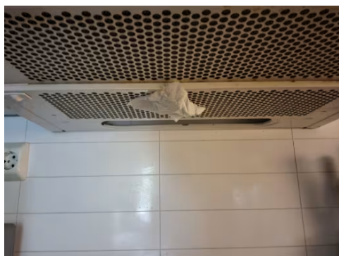
Avtrekkseffekt er testet med papir.
