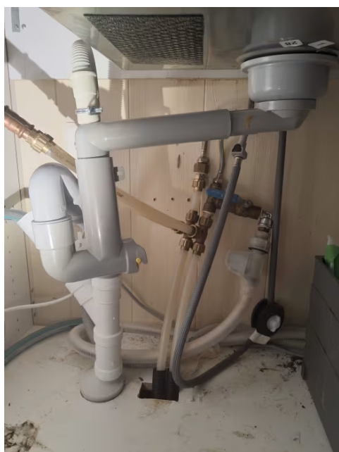
Leiligheten har synlige avløpsrør av plast.
