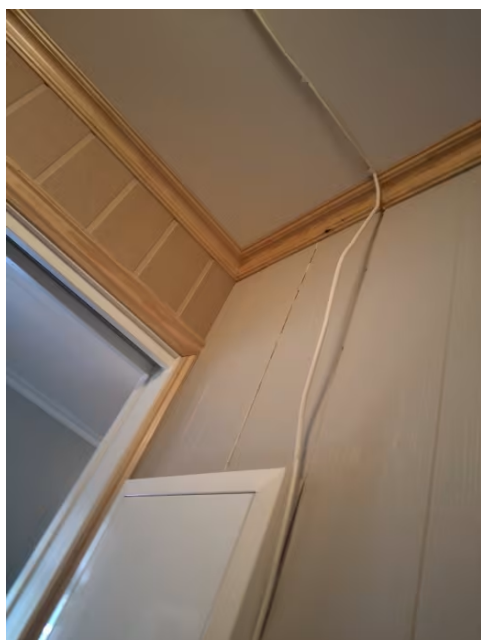
Det registreres enkelte løse kabler.
