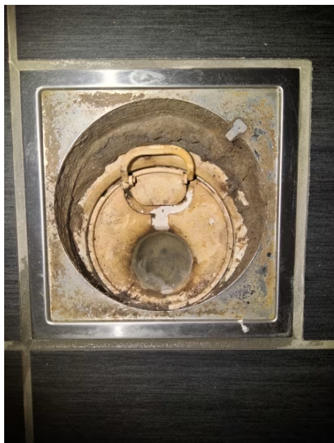
Klemring i sluk er delvis dekket av flislim.
