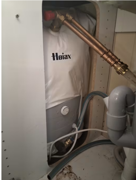
Varmtvannsbereder er plassert i kjøkkeninnredning.
