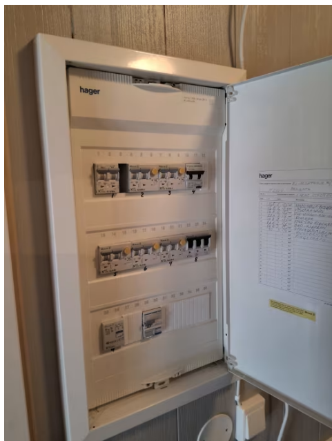
Sikringsskap er plassert i bod.
