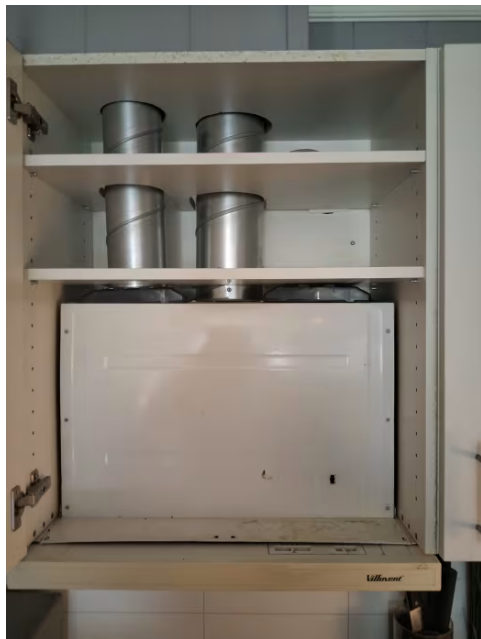
Avtrekkventilator er plassert i overskap over platetopp på kjøkken.
