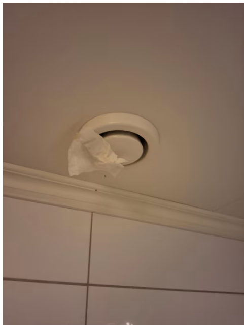
Avtrekkseffekten er testet med papir.
