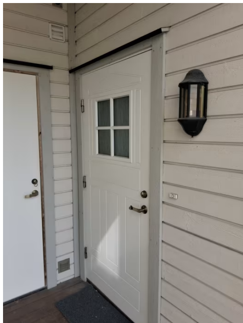
Ytterdør tar i terskel og har behov for justering.
