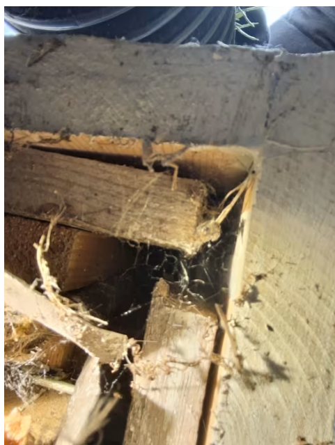
Det registreres manglende musesperre i ett ytterhjørne.
