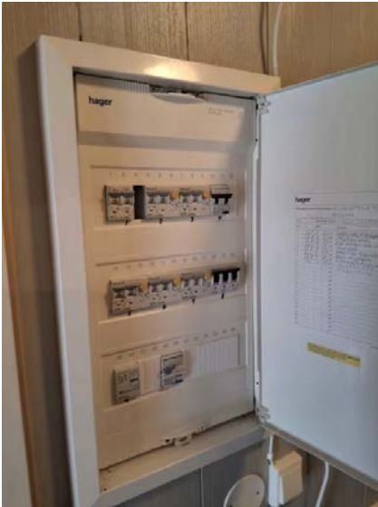
Sikringsskap er plassert i bod.
