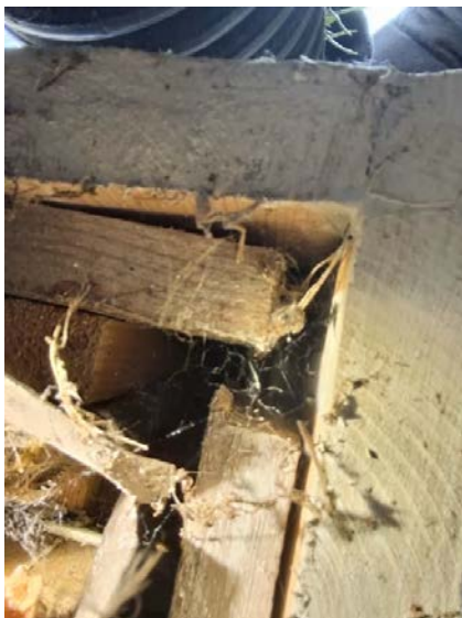
Det registreres manglende musesperre i ett ytterhjørne.
