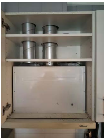
Avtreksventilator er plassert i overskap over platetopp på kjøkken.
