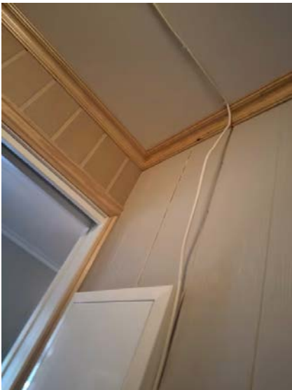
Det registreres enkelte løse kabler.
