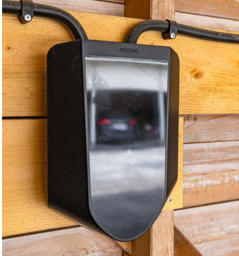
I carporten er det montert elbil-lader.
