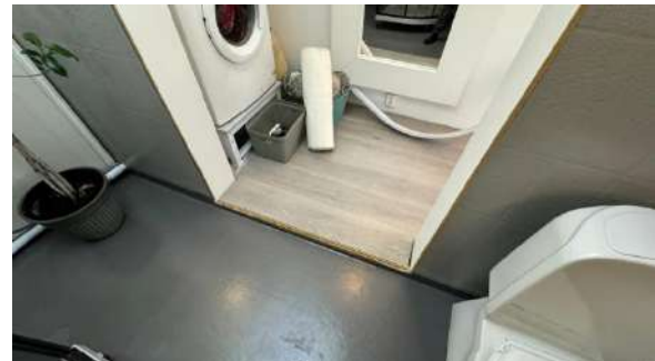
Deler av badet er ikke bygget opp som et våtrom.
