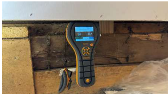
Fuktmåling i bunnsvill fra tilstøtende trapperom.
