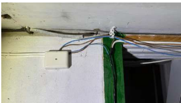
Kabler er ikke tilfredsstillende festet i kjelleretasjen.
