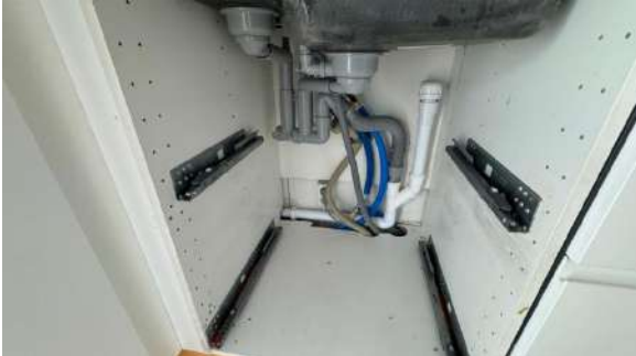
Rør i rør system i kjøkkenbenk.
