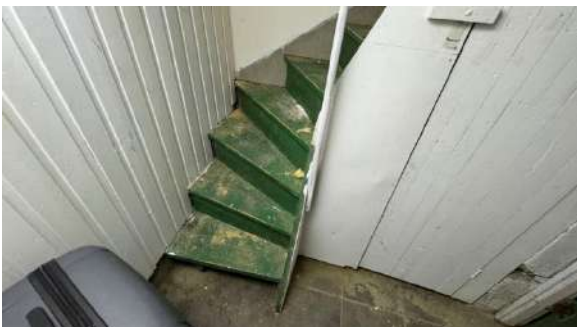
Trapp til kjelleretasjen mangler rekkverk.
