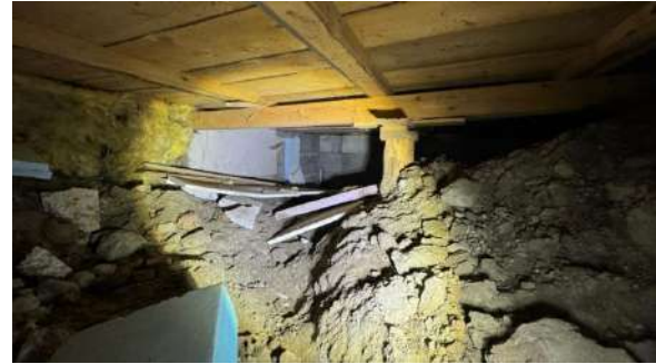
Inspeksjon av krypkjeller. Det er ikke registrert fuktsperre på bakken.
