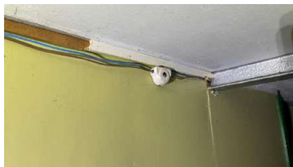
Kabler er ikke tilfredsstillende festet i kjelleretasjen.
