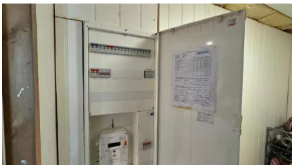
Kontroll av el-skap og kursfortegnelse.
