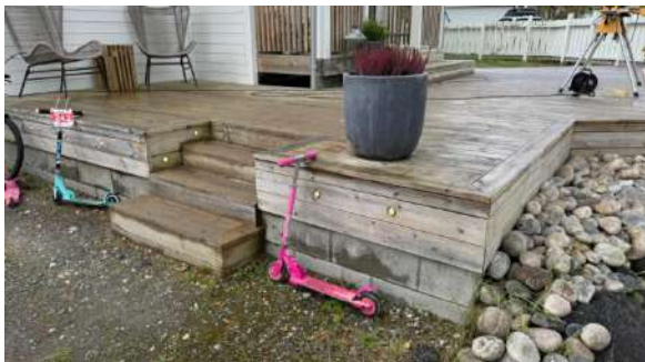
Det er ikke montert rekkverk.
