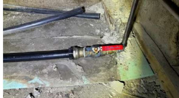
Kontroll av hovedstoppekran.
