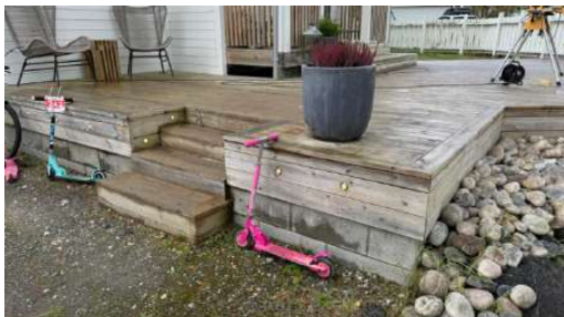
Det er ikke montert rekkverk.
