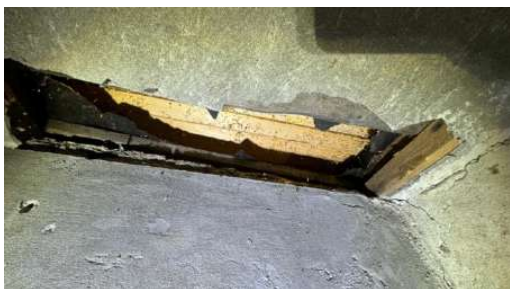
Det er trolig asbestplater i taket i kjelleretasjen.
