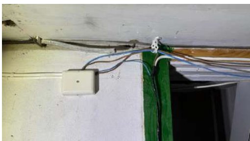
Kabler er ikke tilfredsstillende festet i kjelleretasjen.
