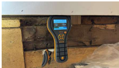
Fuktmåling i bunnsvill fra tilstøtende trapperom.
