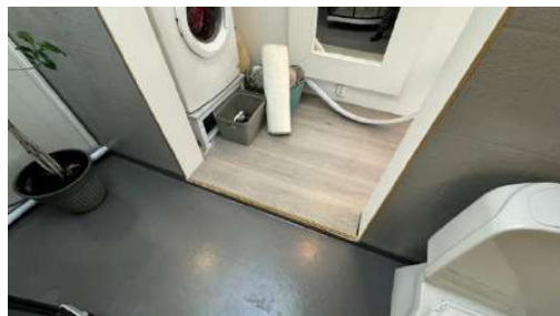
Deler av badet er ikke bygget opp som et våtrom.
