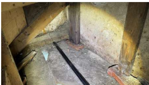
Det er registrert noe råteskade i trappkonstruksjonen.
