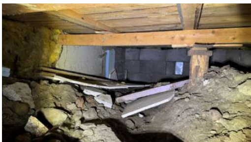
Det er registrert noe provisorisk understøtte av bjelkelag.
