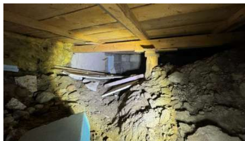
Inspeksjon av krypkjeller. Det er ikke registrert fuktsperre på bakken.
