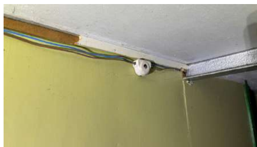
Kabler er ikke tilfredsstillende festet i kjelleretasjen.
