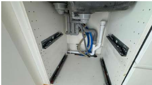
Rør i rør system i kjøkkenbenk.
