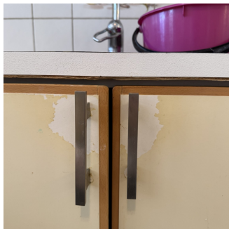
Svelling i benkeplate og slitasje på dør
