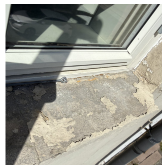
Mangler beslag under vindu.
