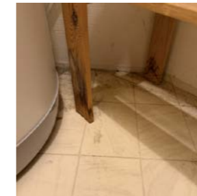
Fuktmerker på innredning
