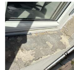
Mangler beslag under vindu.
