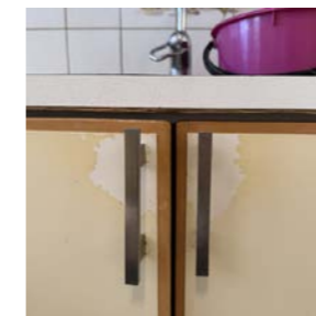
Svelling i benkeplate og slitasje på dør
