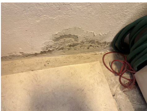
Spor etter fukt i mur.
